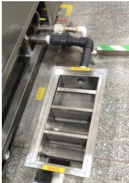
图 3-2 污水处理设施等照片
